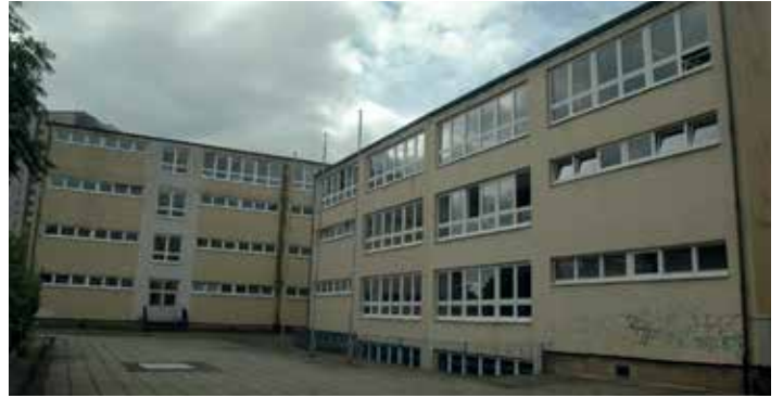
Bei Plattenbauschulen gibt es Sanierungsbedarf.
